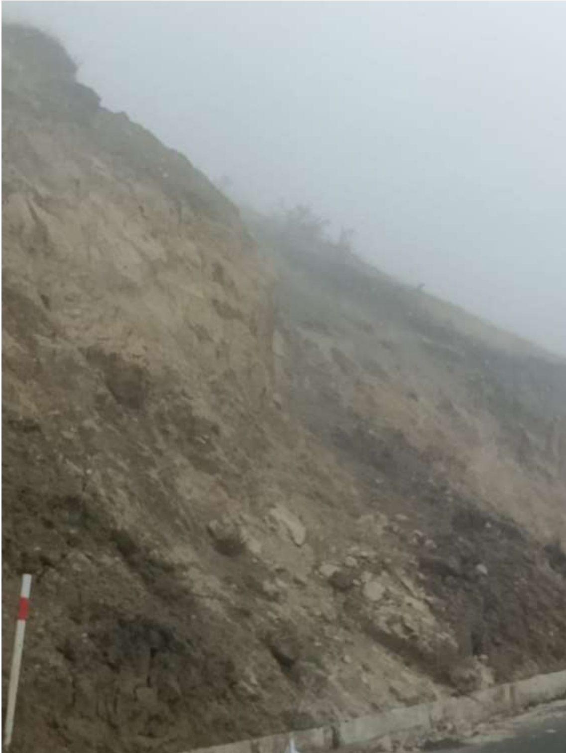
Fotografía 14.- Área con alto riesgo de deslizamiento vía Simiatug – Salinas.
