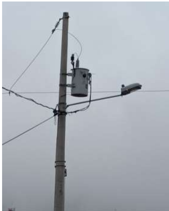
Fotografía 2.- Transformador, elemento expuesto del sistema eléctrico de la parroquia Simiatug. Autores: Yazuma, Piuri, 2021.
