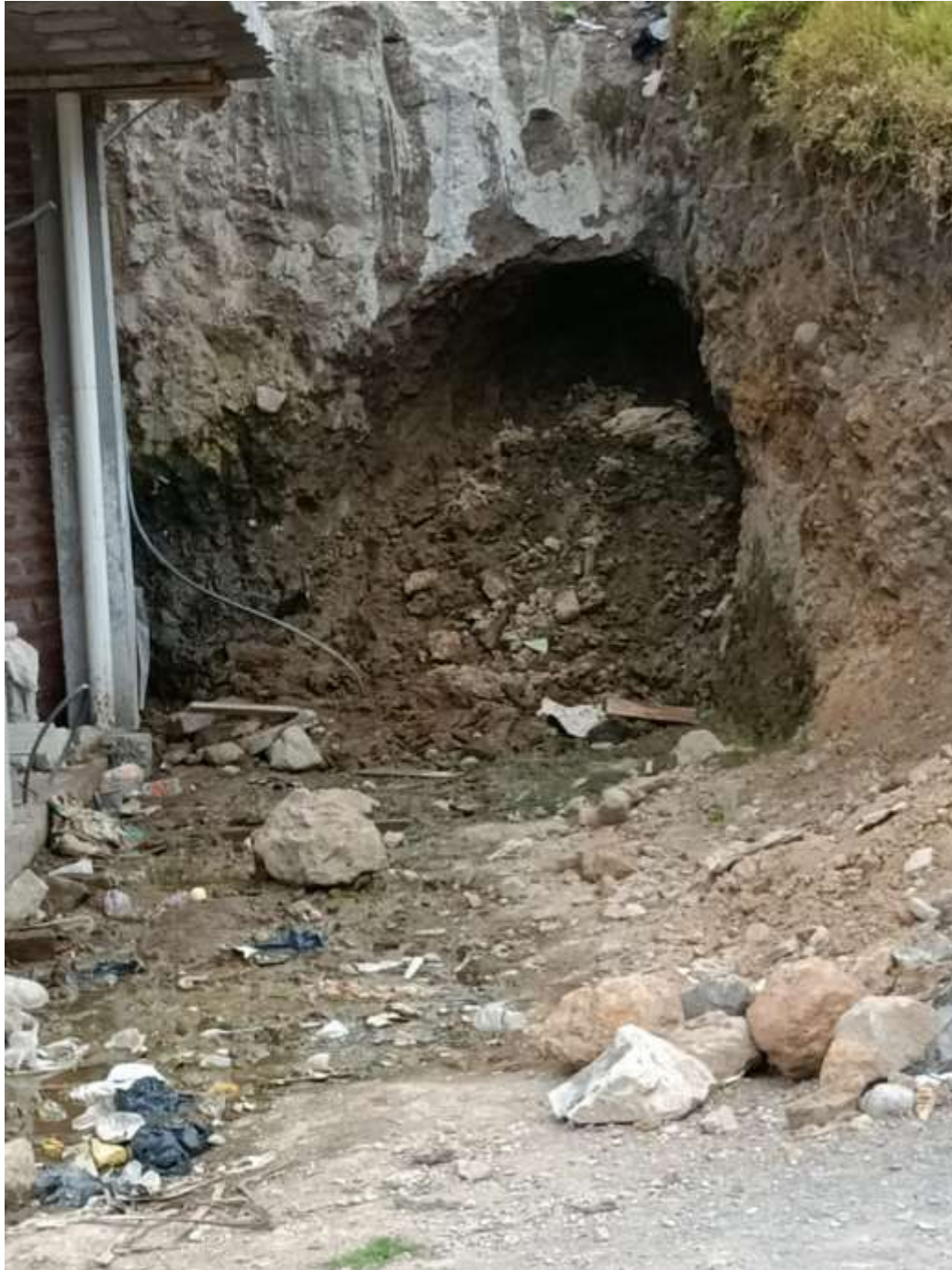
Fotografía 13.- Vivienda con susceptibilidad alta a la amenaza de deslizamiento por vertiente de agua. Autores: Yazuma, Piuri, 2021.
