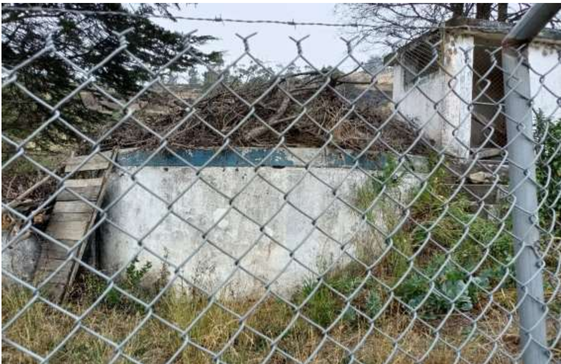
Fotografía 4.- Tanque de almacenamiento de Agua, elemento expuesto del sistema de agua potable de la parroquia Simiatug. Autores: Yazuma, Piuri, 2021.
