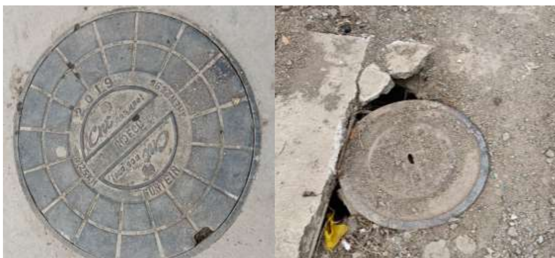
Fotografía 11.- Red de alcantarillado de la parroquia Simiatug. Autores: Yazuma, Piuri, 2021.
