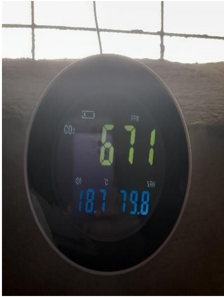
Medición de dióxido de carbono
