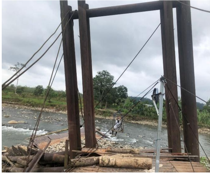
Fotografía 1: Colapso de puente por inundación, sobre el Rio Blanco, Sto. Domingo, 2023.
