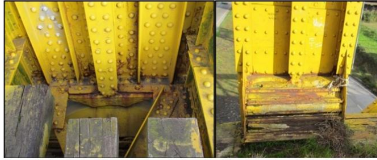
Figura 4. Izquierda, Muestra el grado de oxidación de la viga principal del puente sobre el apoyo. Derecha, muestra la reparación realizada en otro apoyo, al parecer debido a la misma situación. Foto del autor.
