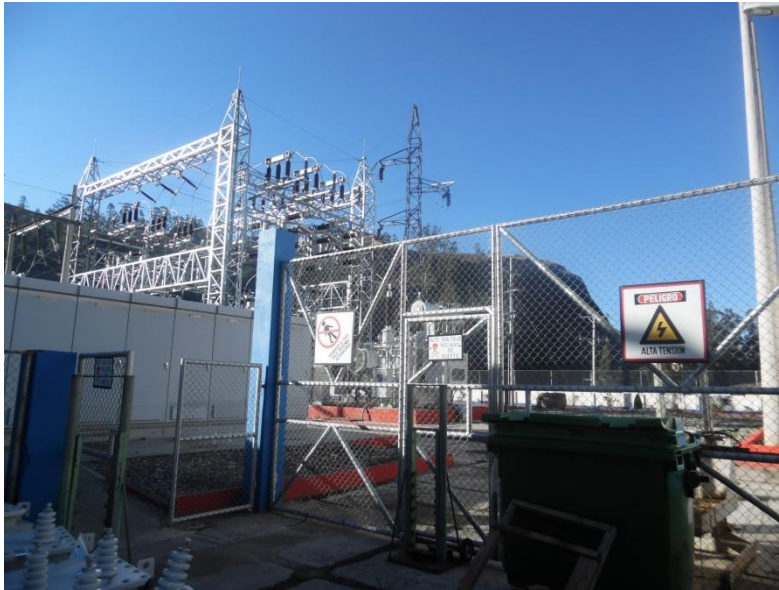
Figura 32. Torres y Transformadores Subestación Guaranda
