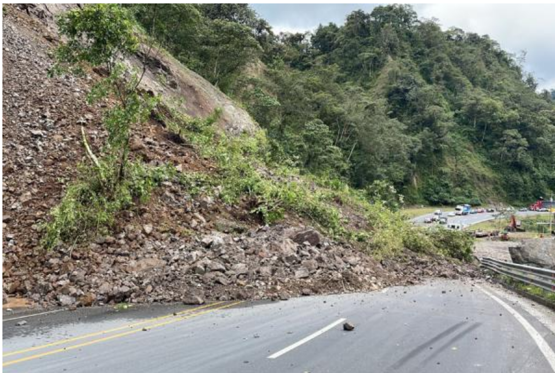
Figura 2 Deslizamiento de tierra.
