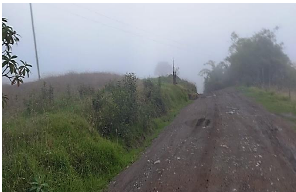
Ilustración 32: Carretero en mal estado que dirige al mirador
