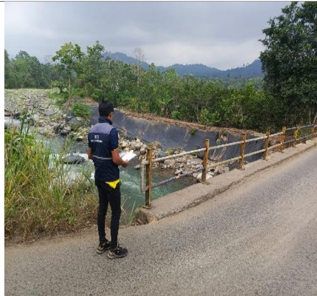
Foto 6. Aplicando la ficha de campo de puente en la zona de influencia del río Pita en el sector San Pablo de Pita.
