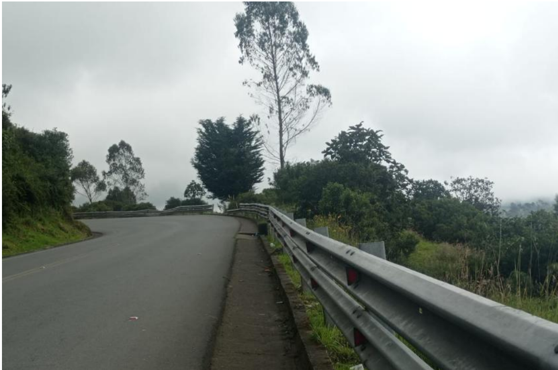
Figura 29. Falta de señalética
