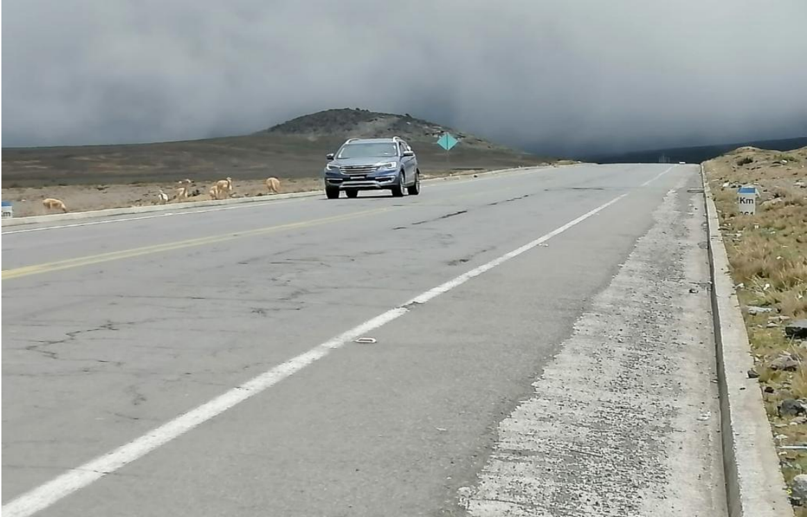
Figura 30. Señalética en mal estado
