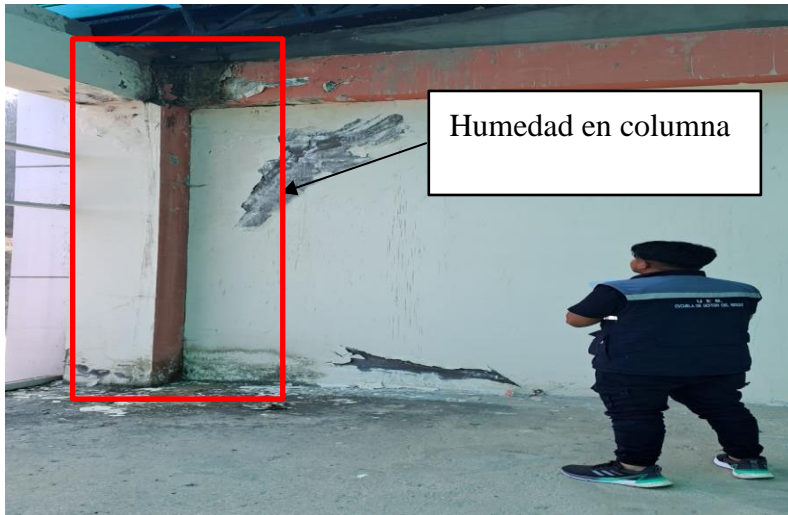
Figura 22 Humedad en paredes de la edificación
