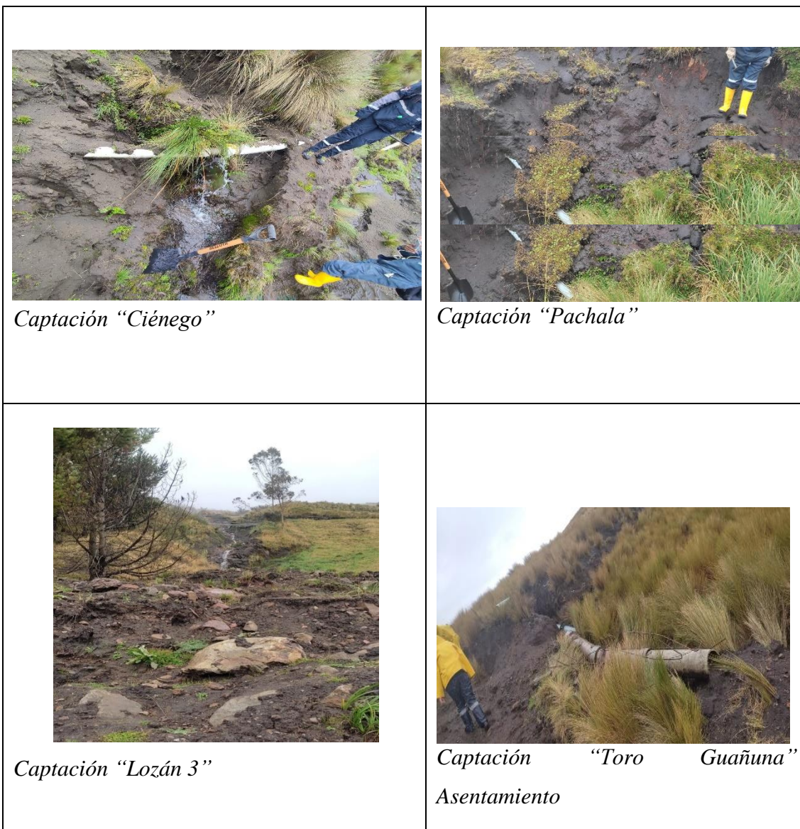
Ilustración 21: IDENTIFICACIÓN DE DESLIZAMIENTOS A LO LARGO DE LA LÍNEA DE CONDUCCIÓN DE AGUA
