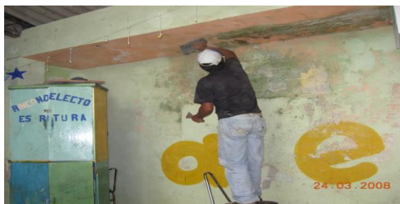
Preparación de las paredes previo a la pintura del ORI "San Francisco".
