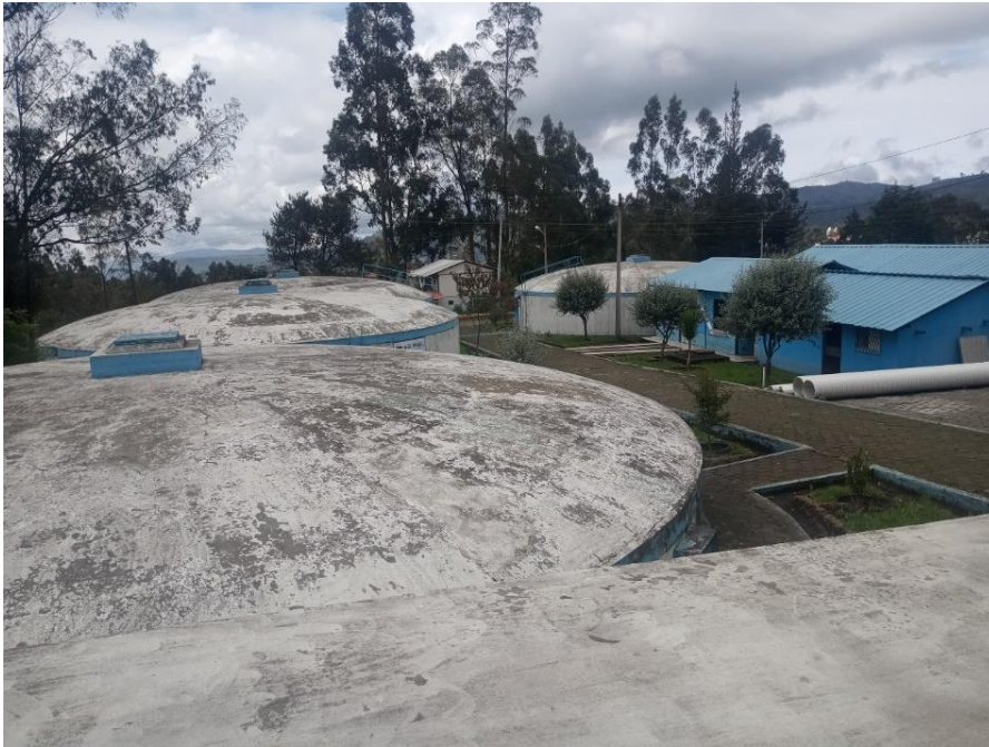
Fotografía 7 Vista de los tanques
