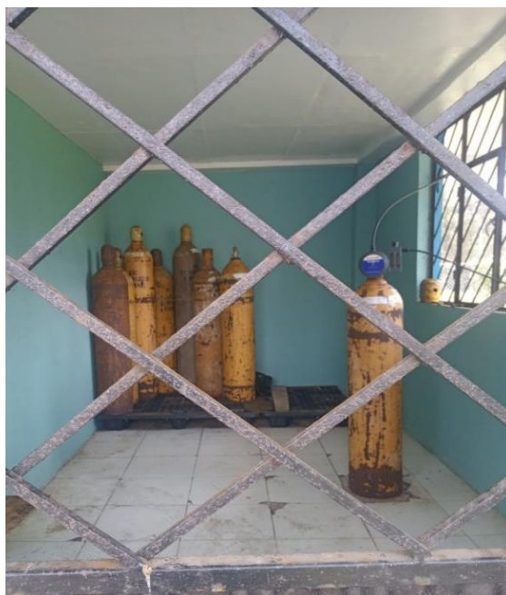
Fotografía 9 Cilindros Cloro Gas
