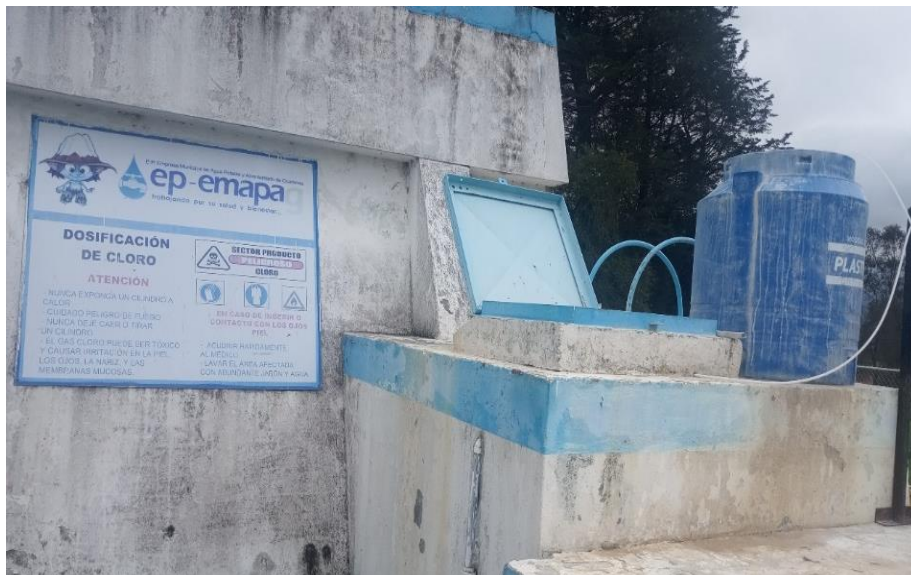
Fotografía 4 Dosificación de cloro
