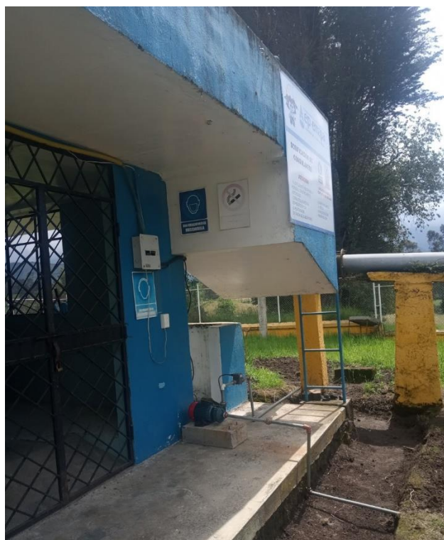
Fotografía 10. Sitio de funcionamiento Cloro gas
