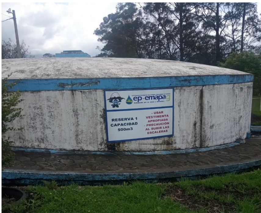
Fotografía 5 Tanque de reserva
