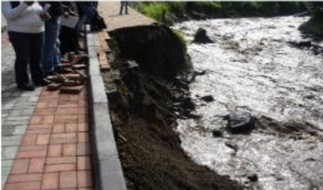
Afectación de crecida del Río Guaranda, sector marco pamba 20-04-2012,
