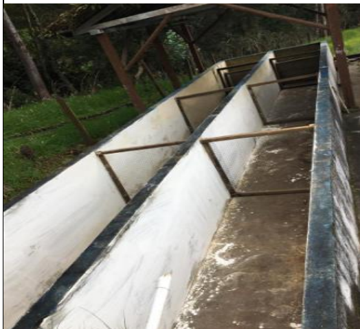
División y desinfección de las piscinas
