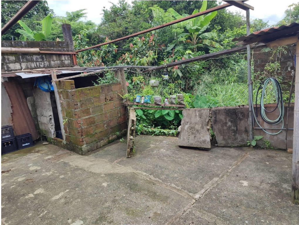
Ilustración 9. Fotografía del daño causado en la época invernal, a causa de un estero que nace y se produce a causa de las fuertes lluvias en una de las viviendas entrevistadas. (2022)
