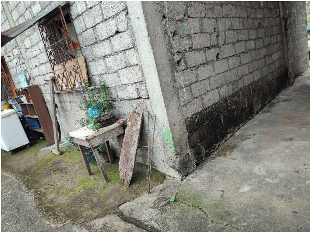
Ilustración 10. Fotografía del rastro del nivel de agua que entra a esta vivienda ubicada cerca a la ribera del río Naves Chico en una de las viviendas entrevistadas. (2022)
