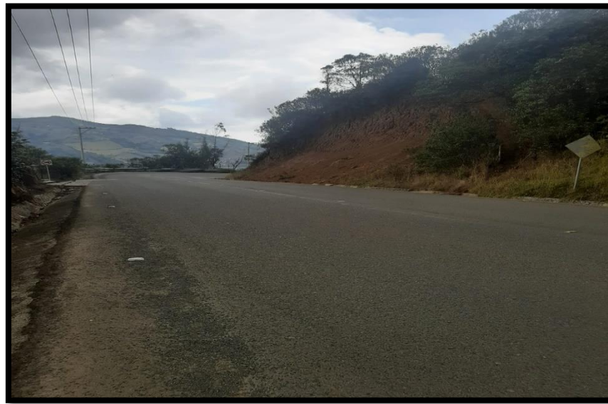
Figura 27. Deslizamiento del punto 4
