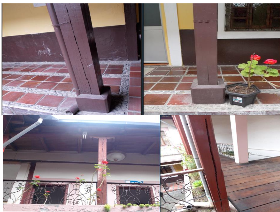
Figura 12. Pilares de madera agrietados
