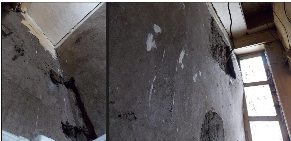
Figura 11. Oquedades en las paredes portantes
