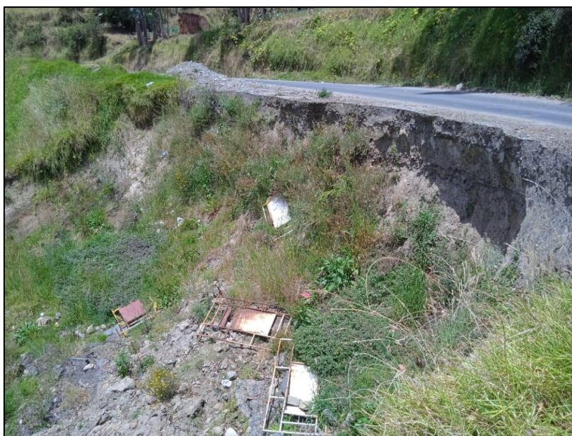
Ilustración 15. Zona de deslizamiento en la microcuenca del río Guaranda, vía Paltabamba y vía al Catillo
