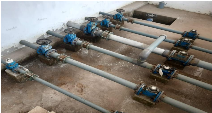
Figura 12 Válvulas de distribución del agua
