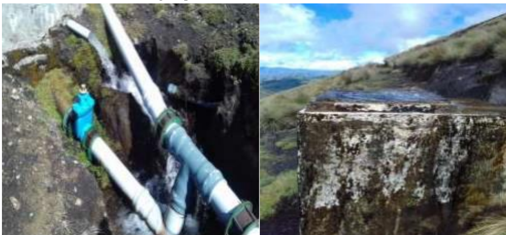
Daños en el sistema de agua potable de la ciudad de Guaranda
