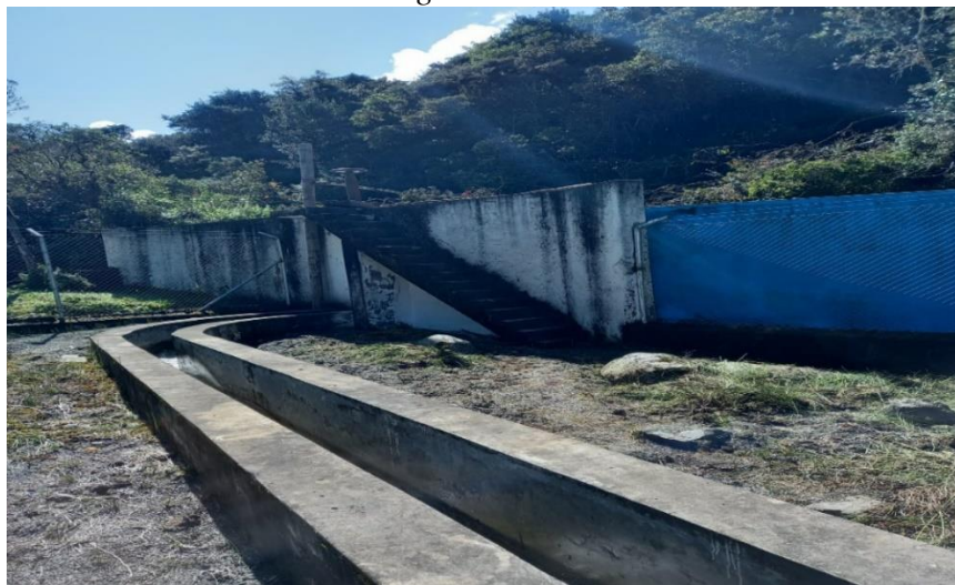
Figura 17 Canales de conducción de agua río
