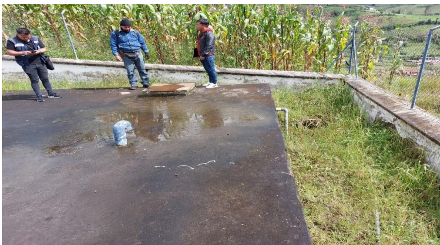
Figura 25 Tanque de reserva de 200m 3
