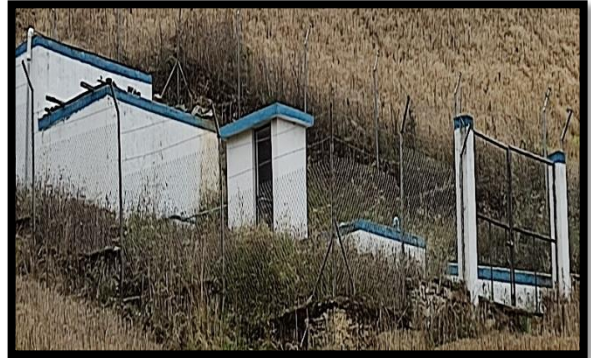
Fotografía 10: Depósito de agua de la parroquia Julio Moreno
