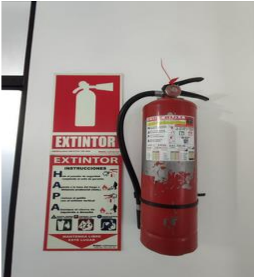
Imagen 9: Extintores de incendio
