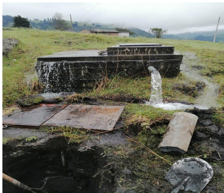
Foto 2: Infraestructura en malas condiciones.
