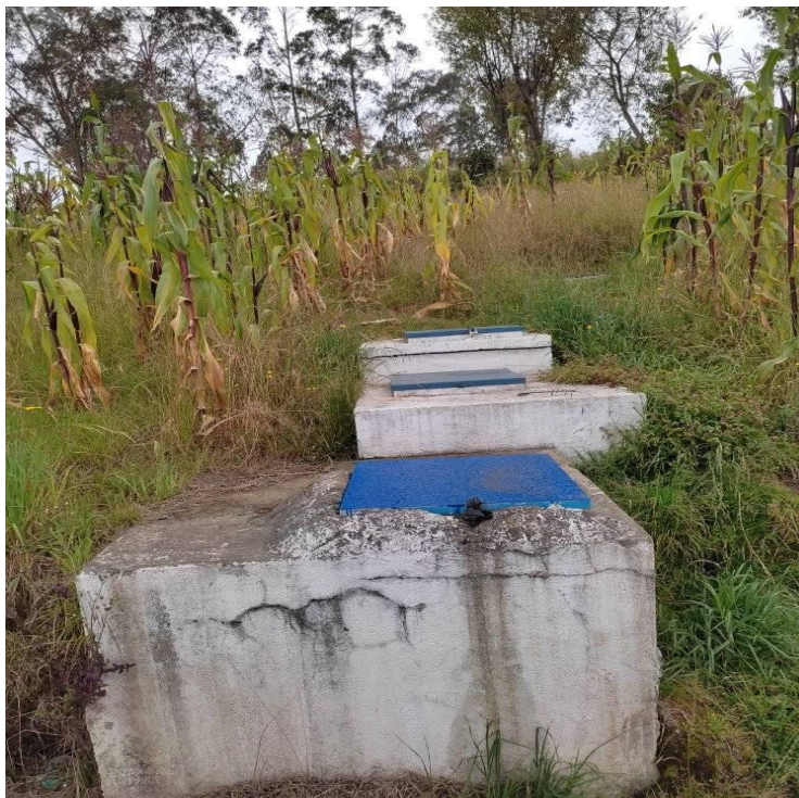
Foto 12: Tanque de revisión..
