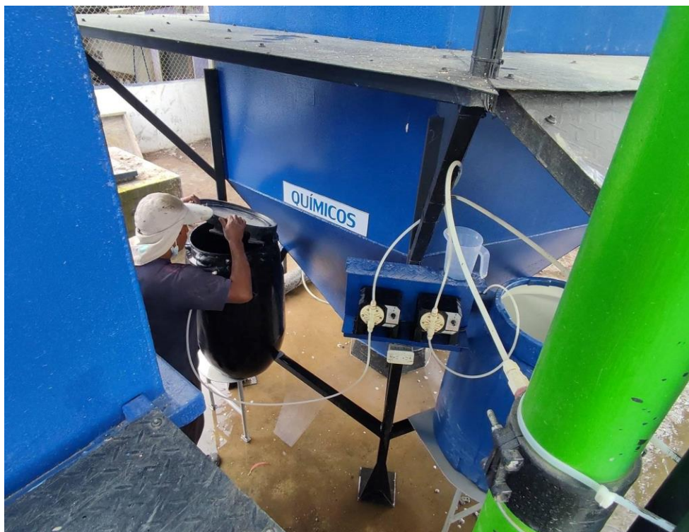
Foto 9: Tanque de químicos.
