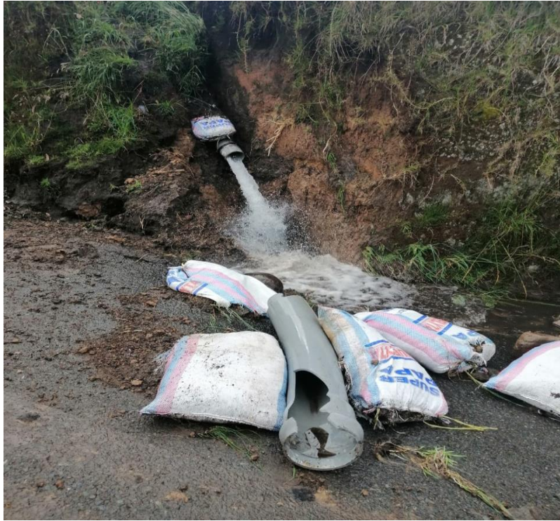
Foto 3: Rotura de tubería por Mayor presión de agua.
