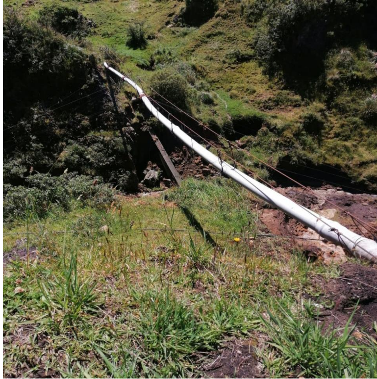
Foto 5: Tuberías en forma aéreas.
