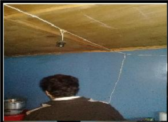
Foto 05 Sistemas electricos en mal estado - Techo falso combustible
