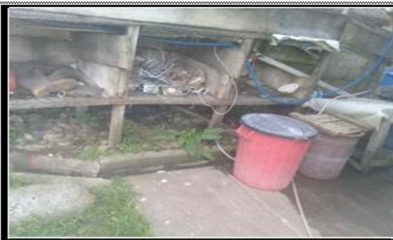
Foto 08 Sistema electrico expuesto en material combustible Autor: Oscar, 2019
