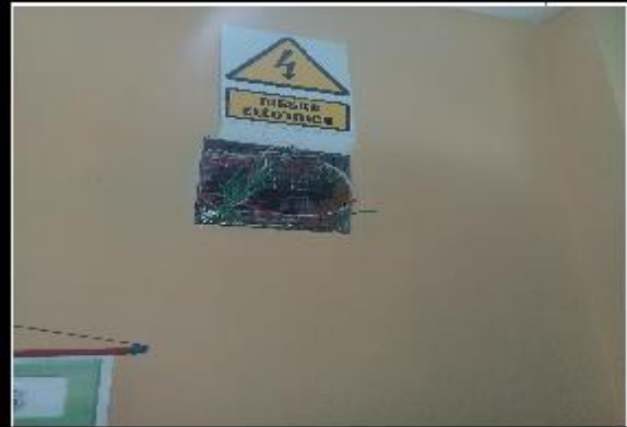
Foto 06 Sistema electrico en mal estado - sin cubierta de proteccion.
