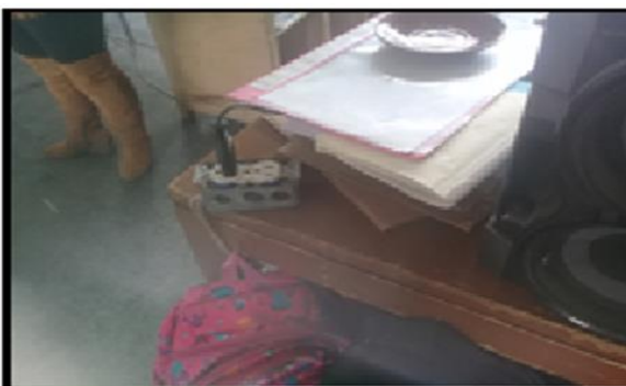
Foto 09 Sistema electrico expuesto en material combustible
