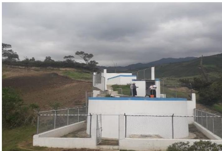
Tanque de tratamiento
