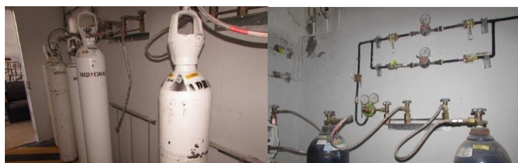
Figura 16 Bombonas no presentan anclaje
