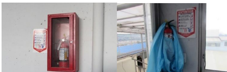
Figura 18 Estado de los extintores
