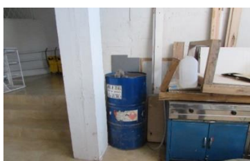
Figura 15 Tanque de almacenamiento de combustible junto a elementos inflamables
