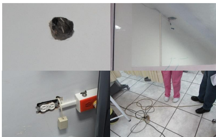
Figura 20 Inseguridad eléctrica por falta de seguridades.
