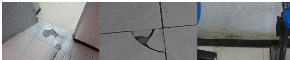
Figura 19 Piso deteriorado y barrederas desprendidas
