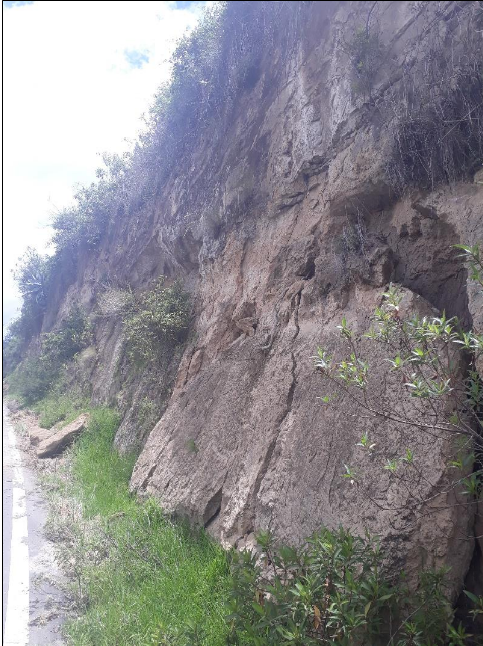
Fotografía 4: Desprendimientos de grandes montículos de tierra sobre las cunetas vía Guaranda - Pircapamba
