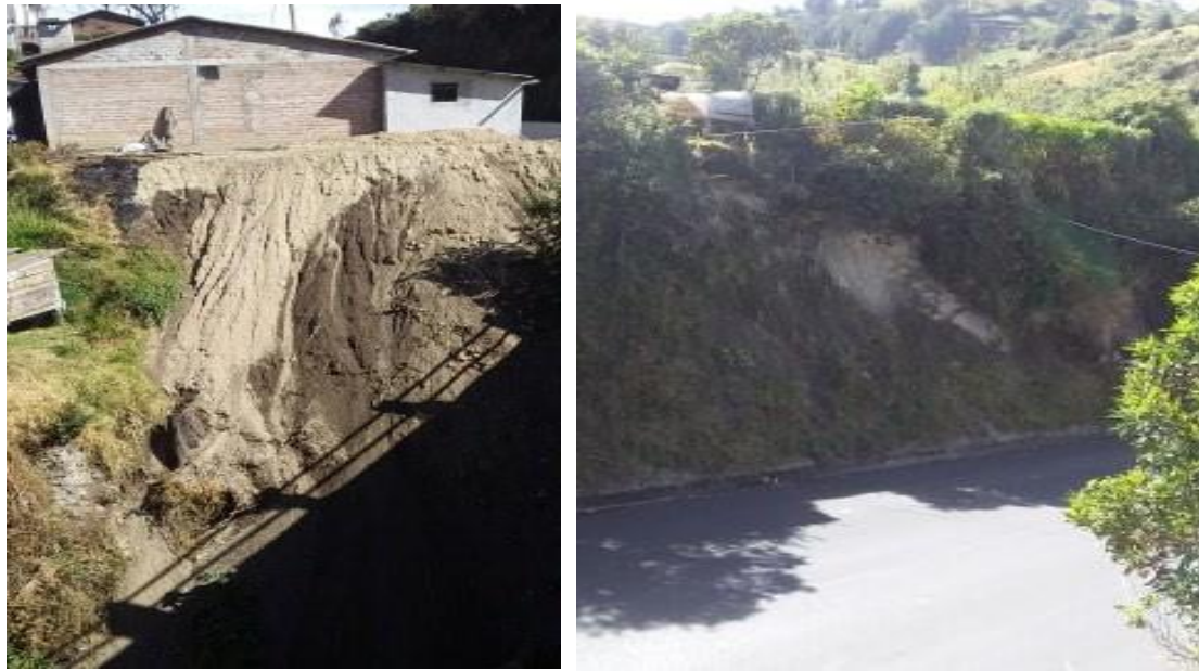
Viviendas con nivel alto de vulnerabilidad comunidad La Vaquería. (Masabanda, 2019)
