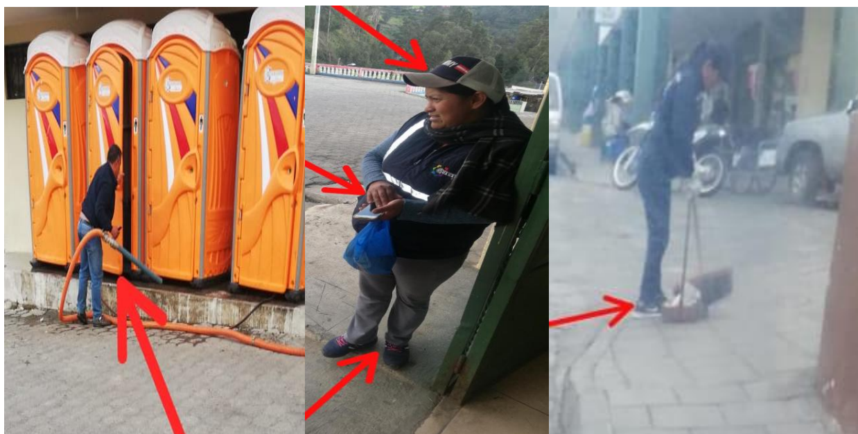
Figura 33: Trabajador sin elementos de protección personal. Nota: No utilizan los elementos de protección personal adecuados y necesarios para evitar cualquier tipo de accidentes. Elaboración: Equipo de trabajo.
