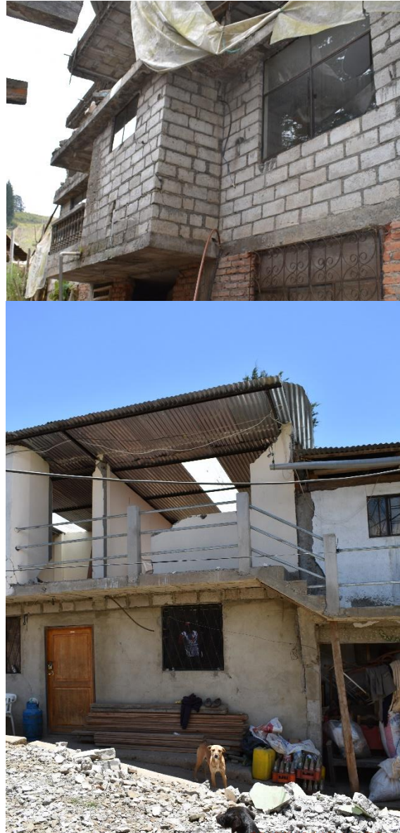
IMAGEN 19. Afectacion a las edificaciones.
