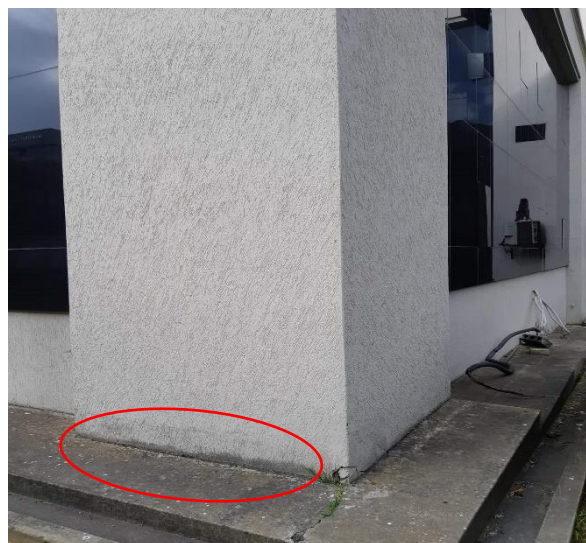
Figura 15: Asentamiento de la Edificación
