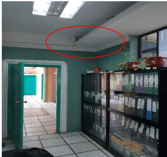
Figura 20: Fisura en la losa
