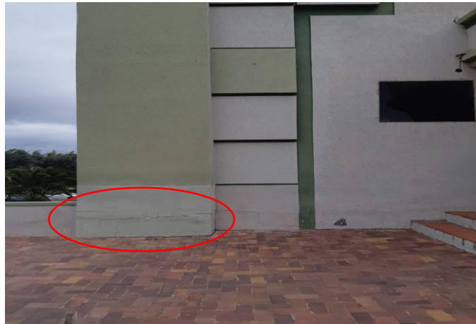
Figura 14: Fisura Exterior, producida después de los sismos.
