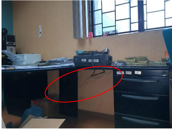
Figura 21: Fisura en pared
