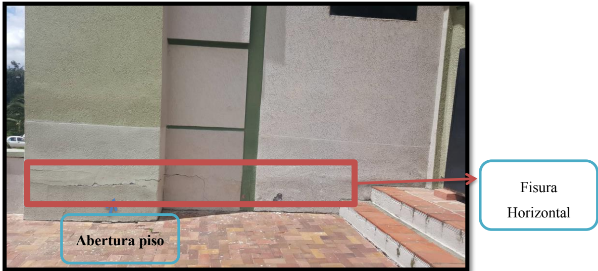
Fotografía 5: Fisura horizontal Autores: Andrade y Escobar, 2019 Fecha: 24/04/2019
