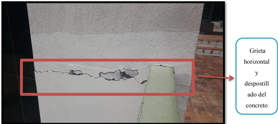
Fotografía 1: Identificación de grietas Autores: Andrade y Escobar, 2019 Fecha: 24/04/2019
