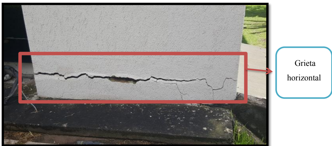
Fotografía 2: Grieta horizontal Autores: Andrade y Escobar, 2019 Fecha: 24/04/2019
