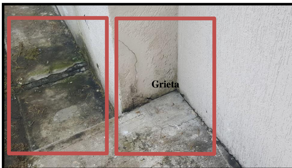
Fotografía 4: Identificación de grieta, humedad Autores: Andrade y Escobar, 2019 Fecha: 24/04/2019
