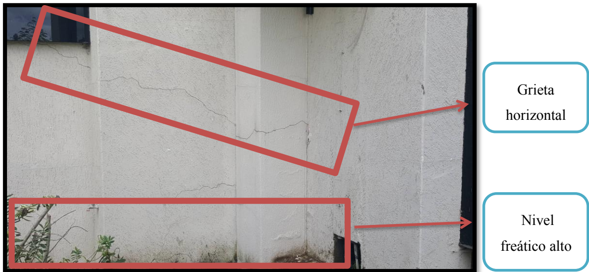
Fotografía 3: Identificación de grieta, humedad Autores: Andrade y Escobar, 2019 Fecha: 24/04/2019
