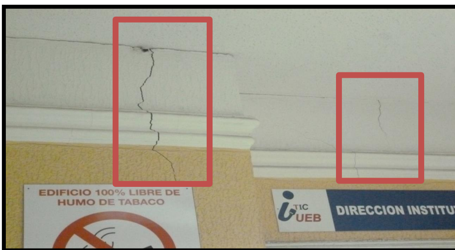
Fotografía 8: Identificación de fisura, grieta Autores: Andrade y Escobar, 2019 Fecha: 24/04/2019
