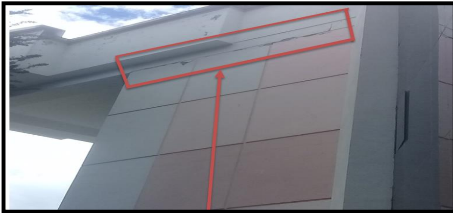
Fisuras presentadas en la fachada lateral derecho del edificio.
