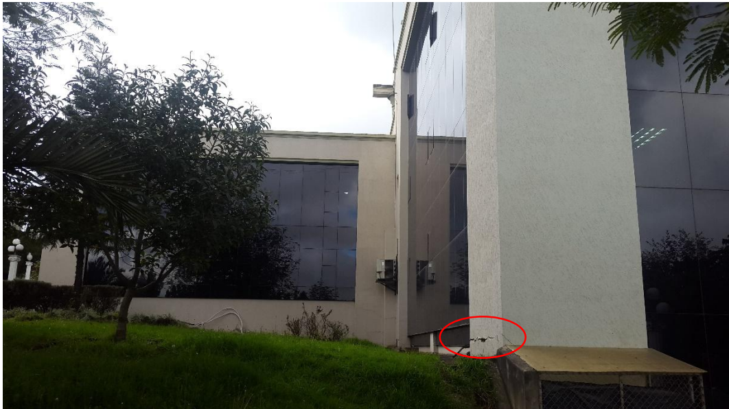
Gráfico 17: Grietas identificados en el edificio
