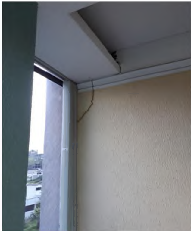
Anexo 18: Presencias de fisuras oficina del vice rectorado Fuente: Trabajo de campo, 2019 Autores: Pazmiño y Pico
