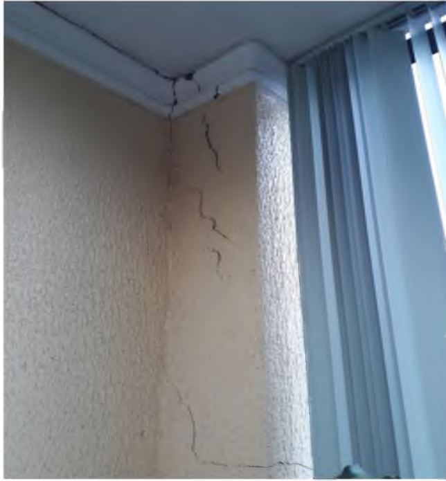
Anexo 17: Presencia de fisuras oficina de vice rectorado Fuente: Trabajo de campo, 2019 Autores: Pazmiño y Pico
