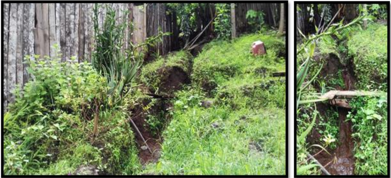
Foto No 7. Zanjas cerca de viviendas producto de las escorrentías superficiales y consecuente erosión hídrica del suelo
