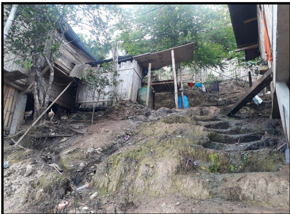
Foto No 6. Zanjas cerca de viviendas producto de las escorrentías superficiales y consecuente erosión hídrica del suelo
