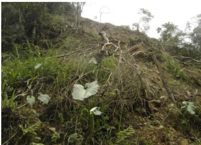
Fotografía 15 Inestabilidad de talud en el Terreno de santa Inés
