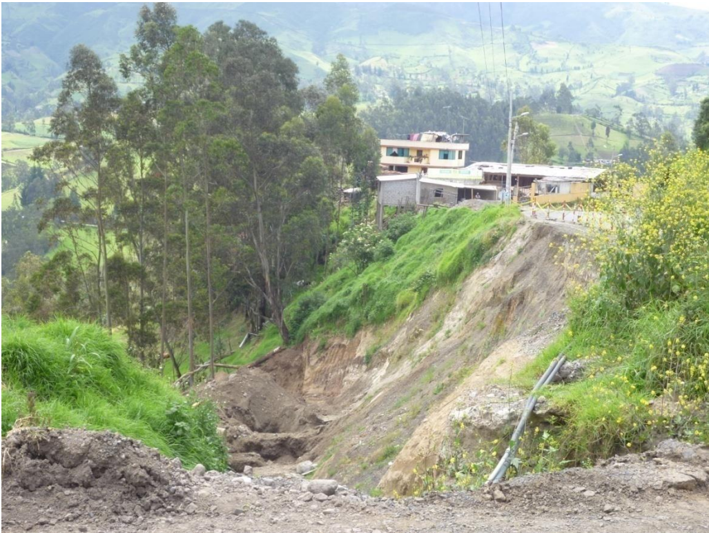
Se puede observar deslaves alrededor de la quebrada que colinda con la Panamericana norte
