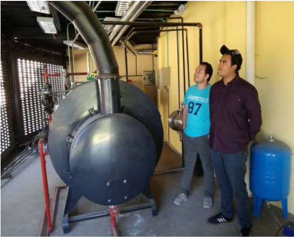
Ubicación y estructura externa del caldero
