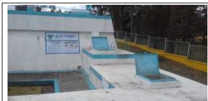
Fotografía #4 Cámara de contacto de cloro Recorrido de observación Planta de Tratamiento
