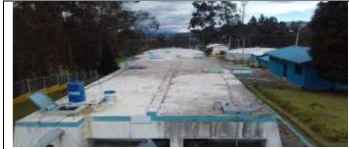
Fotografía #3 Tanque Sedimentador Recorrido de observación
