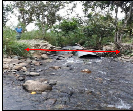
Foto 13. Afectaciones históricas a medios de conectividad.
