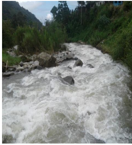
Foto 35 Destruccion del muro de gaviones por las credidas del Rio Cristal.
