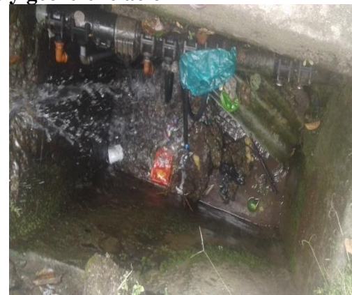
Foto 18 Sistema de alcantarillado sanitario.
