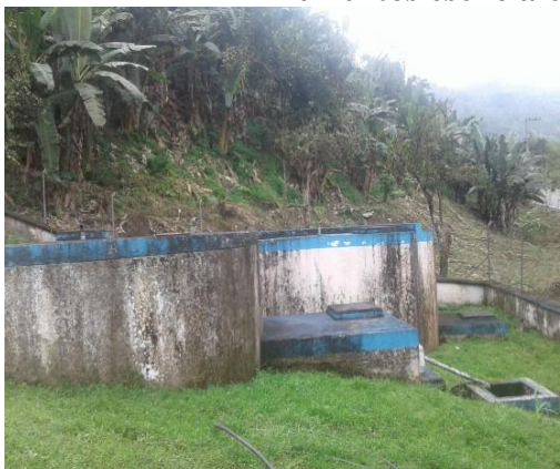
Foto 17 Tanque de tratamiento del agua potable en la Parroquia Balsapamba.
