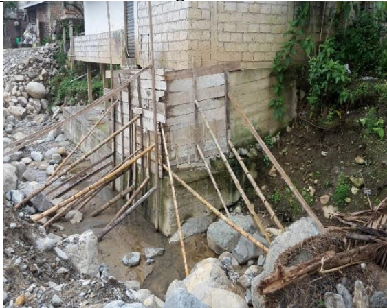
Viviendas debilitadas en sus cimientos
