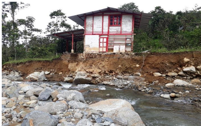
Vivienda ubicada en las riberas del río a punto de colapsar
