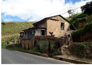
Foto 4.6. Edificación nivel de vulnerabilidad alto
