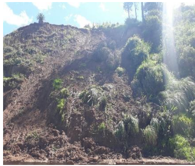
Foto 4.9. Deslizamiento en el sector de Casaguayco
