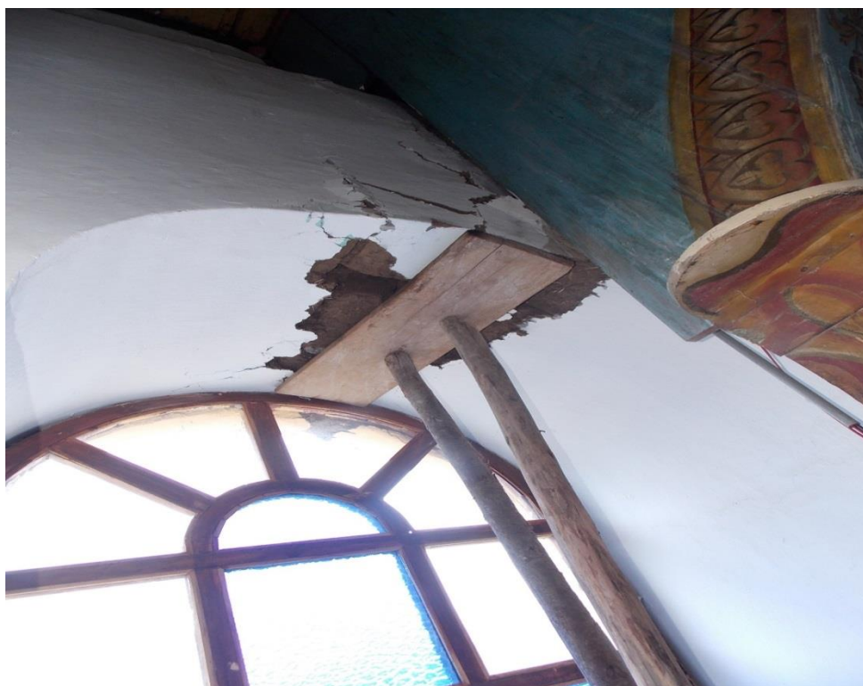
Fotografía 5 Fisura parte Superior del arco. Fuente: Recorrido de observación. Elaboración: Mendoza y Guaranda. 15-04-2017
