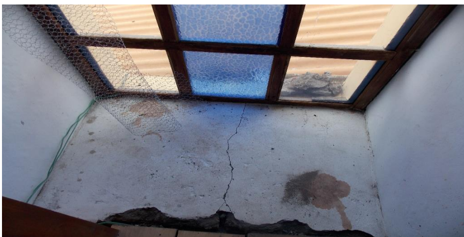
Fotografía 10 Fisura en base de ventana pared posterior. Fuente: Recorrido de observación. Elaboración: Mendoza y Guaranda. 15-04-2017
