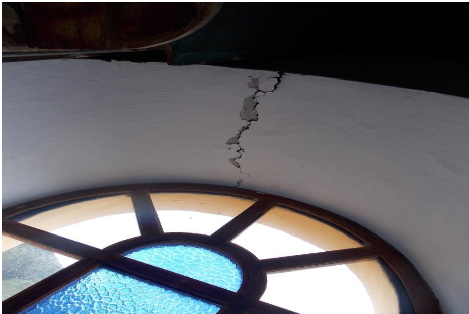
Fotografía 9 Fisura arco de ventana pared posterior 2 Fuente: Recorrido de observación. Elaboración: Mendoza y Guaranda. 15-04-2017
