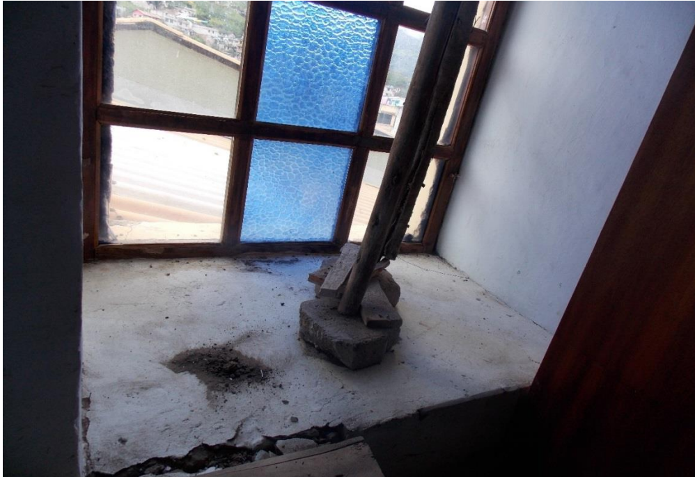
Fotografía 6 Fisura parte inferior del arco
