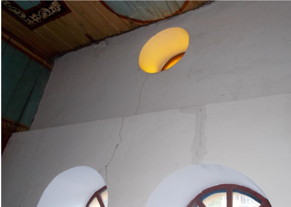
Fotografía 7 Fisura interna en la pared frontal Fuente: Recorrido de observación Elaboración: Mendoza y Guaranda. 15-04-2017
