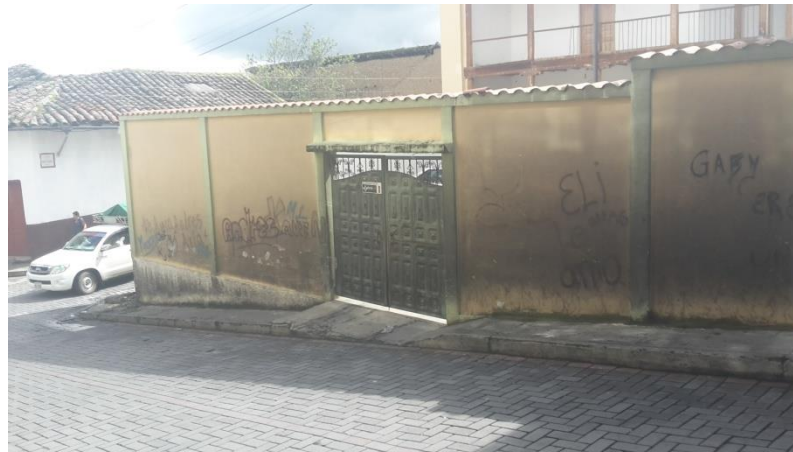
Foto 5.- Hollín impregnado en las paredes por la emisión de dióxido de carbono
