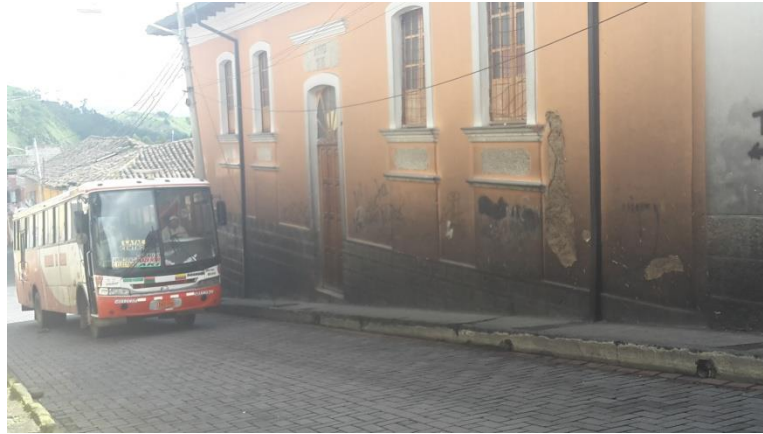
Foto 4.- Hollín impregnado en las paredes por la emisión de monóxido de carbono arrojado por el transporte de servicio público urbano (Universidad de Bolívar)
