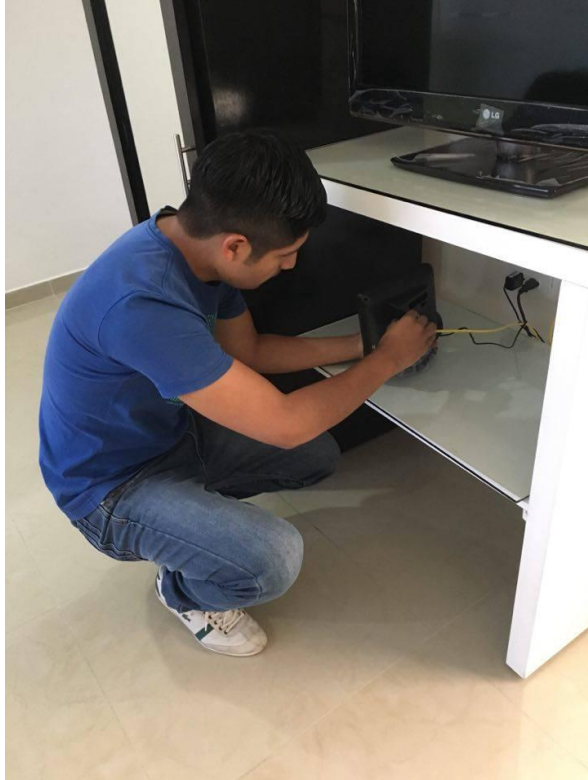
Figura 7.50 Suite Instalación teléfono VoIP
