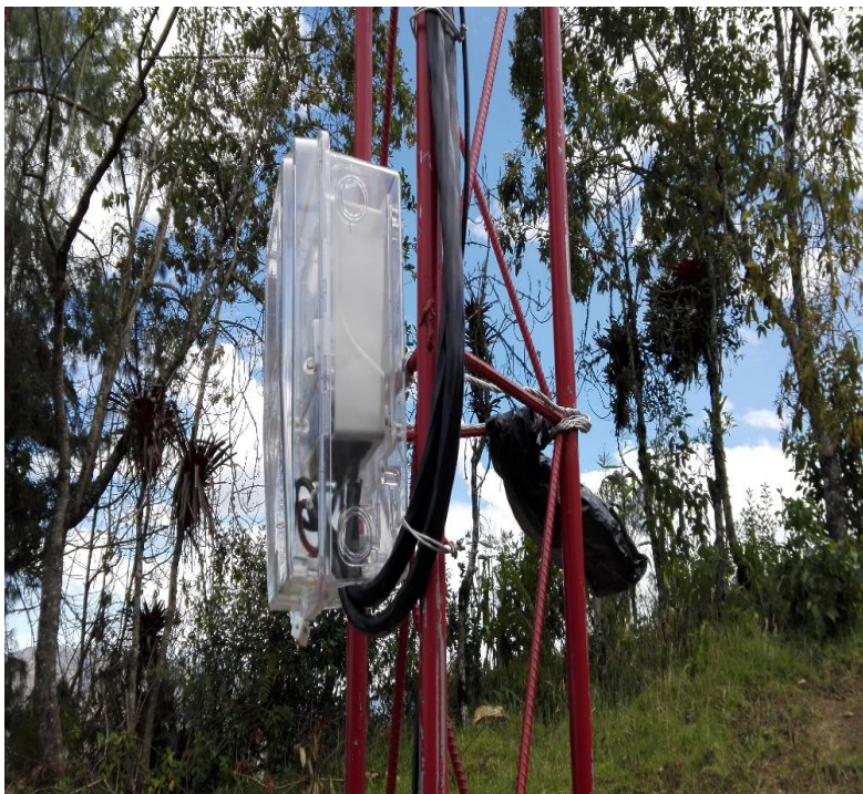
Figura 58: Conexión de energía eléctrica.
