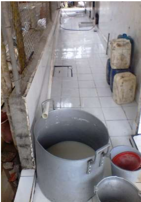
Tubería de desagüe del suero
