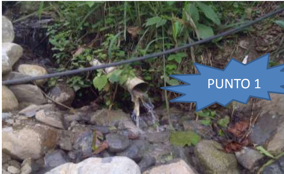
Descarga del efluente (Punto uno)
