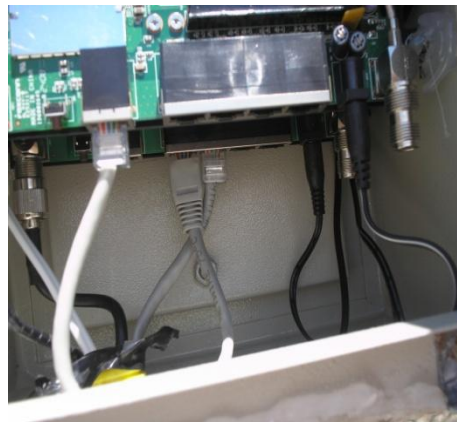
Fig. 2.82 Conexión interna del Router al Access Point
