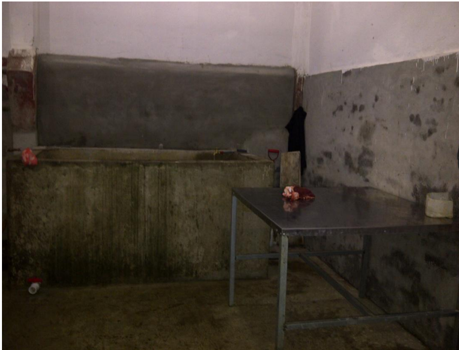
Tanque de agua del camal
