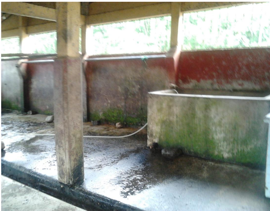
Tanque de agua del camal
