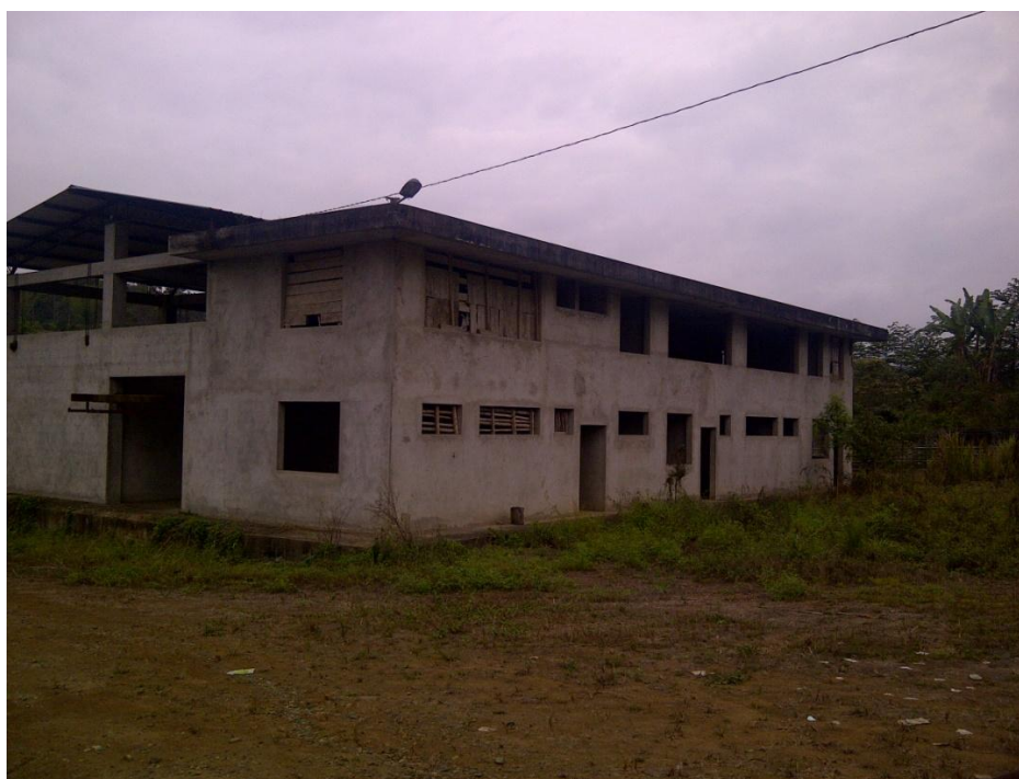
Vista lateral de la nueva estructura en desuso y deteriorándose
